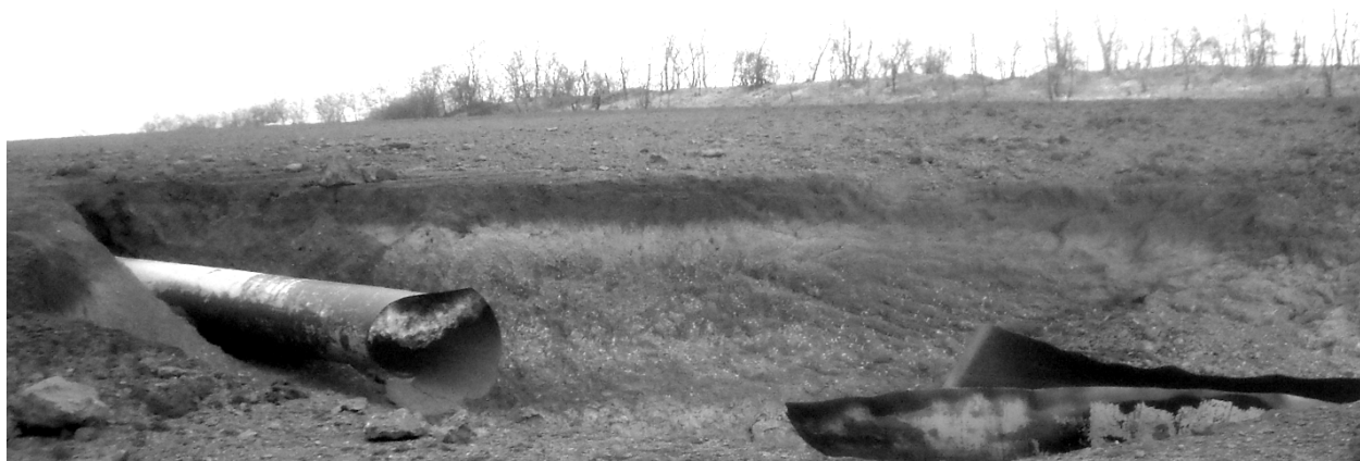
Рис.1. Место разрыва трубы
